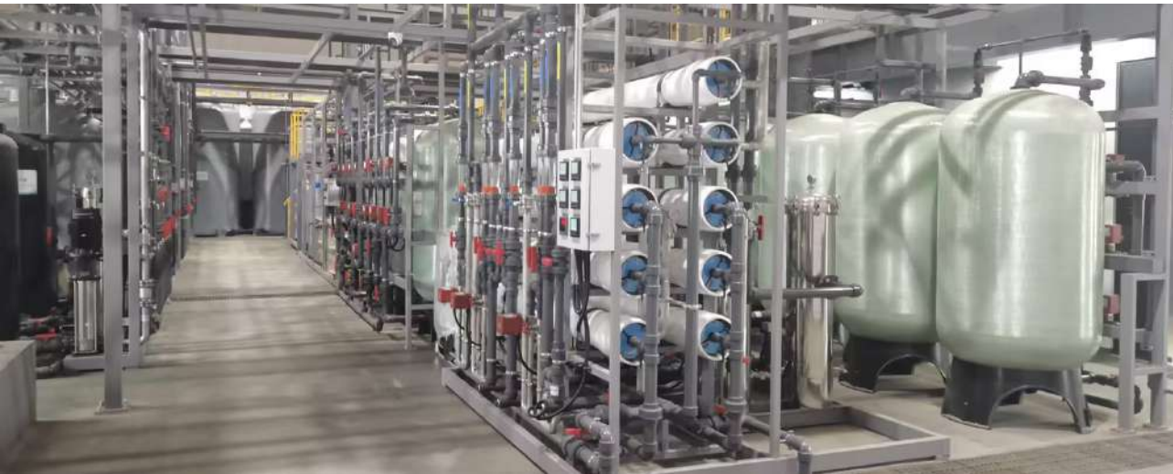
公司电镀废水处理系统
