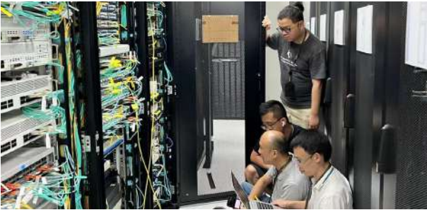
公司工程师调试 IT 设备
