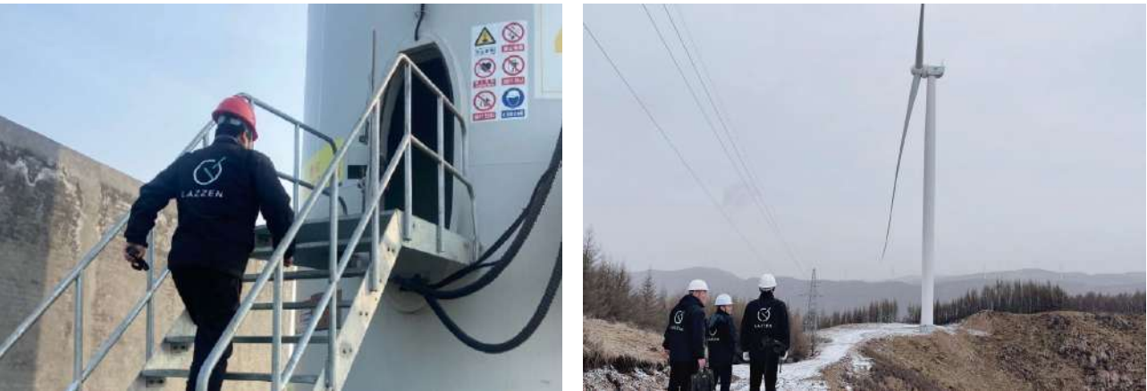
风电项目故障现场检修排查
