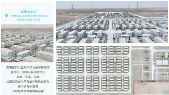
塔里木油田发电侧储能电站项目
