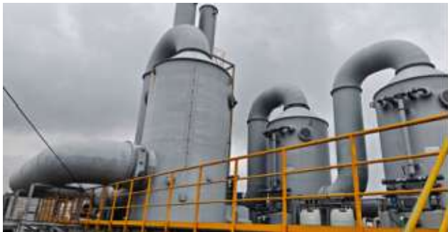
废气处理装置
