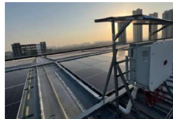
500KW 光伏电站
